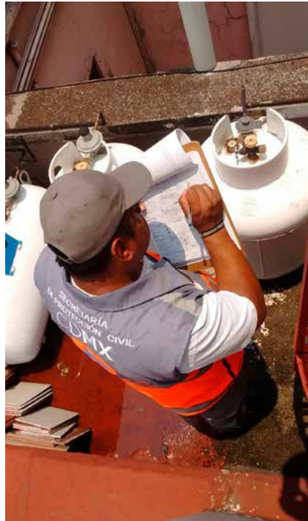
Revisión a tanques de gas L.P.
