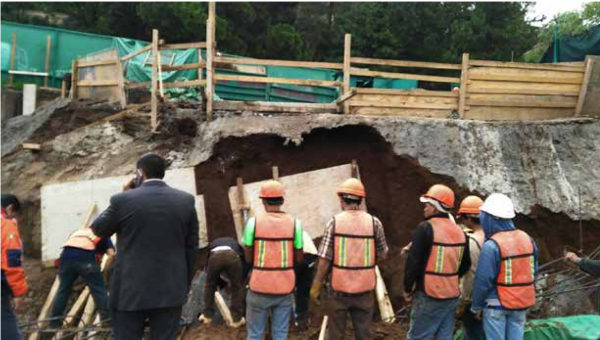
Deslizamiento en obra en proceso de construcción en la delegación Cuajimalpa.
