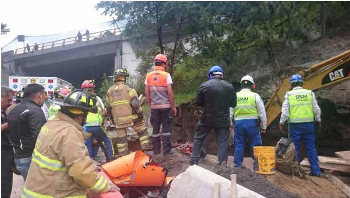
Deslizamiento de tierra en la delegación Cuajimalpa.
