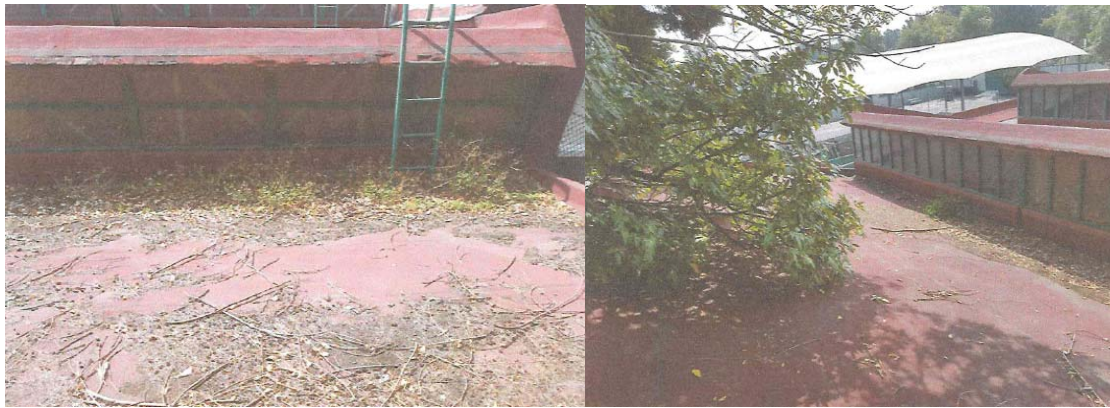
Imágenes 9: Estado de la infraestructura y equipamiento antes de la intervención de Mejor Escuela
