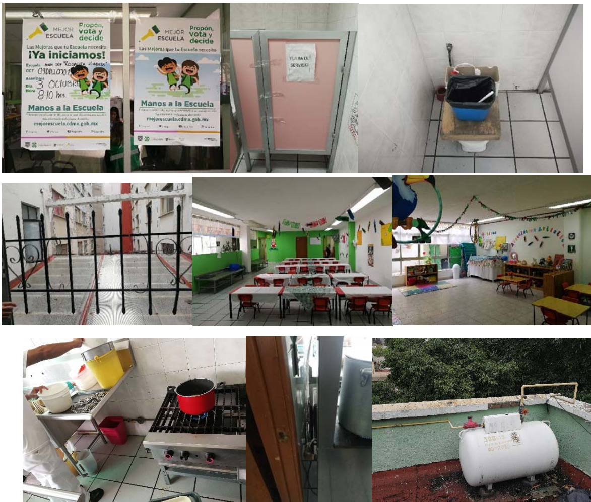
Imágenes 6: Estado de la escuela en general antes de la intervención de Mejor Escuela
